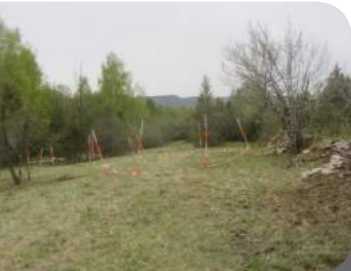
PIQUETAGE DE LA STATION PENDANT LES TRAVAUX. RENDU AVANT ET APRÈS TRAVAUX
